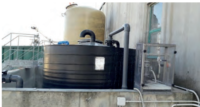
Impianto di depurazione Monsigliolo- Cortona: Adeguamento dello stoccaggio chimico di acido acetico e alluminato di sodio.
