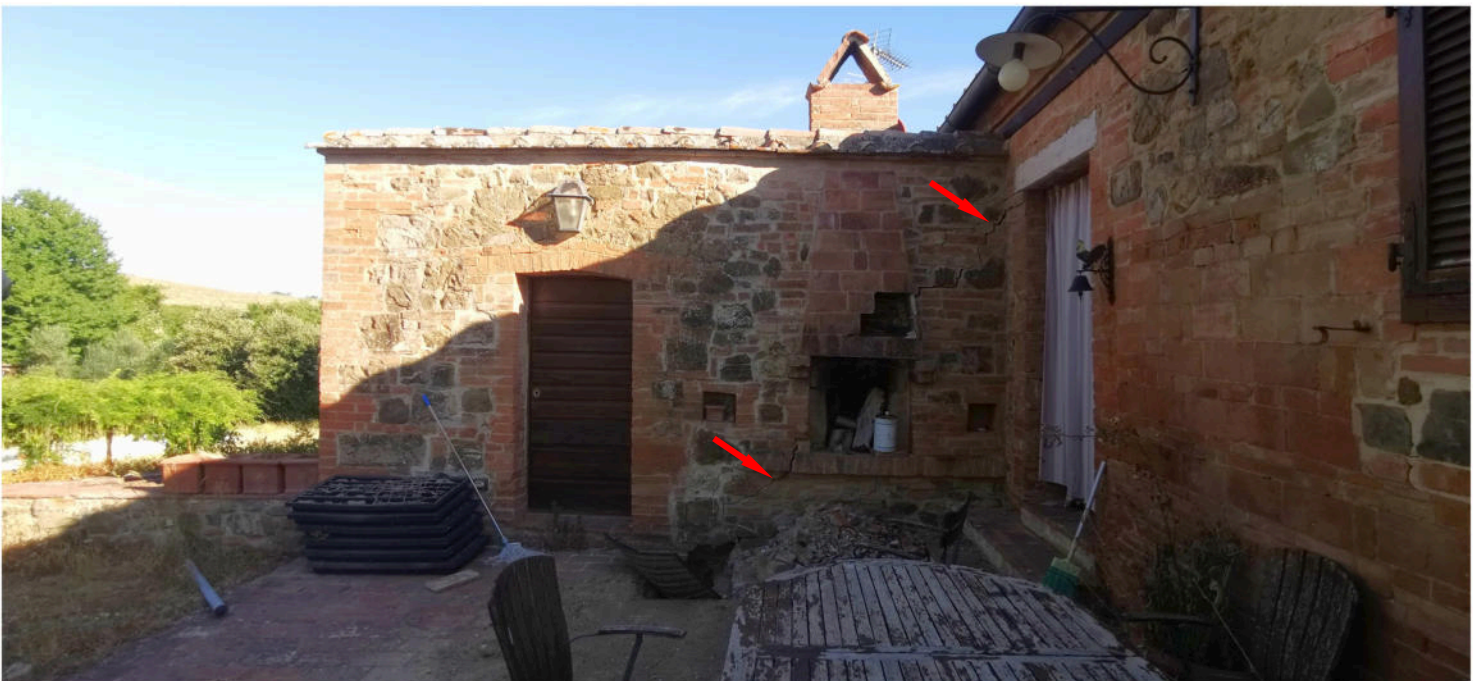
Foto 2 - Ingresso corpo minore 1 con evidenziazione delle lesioni
