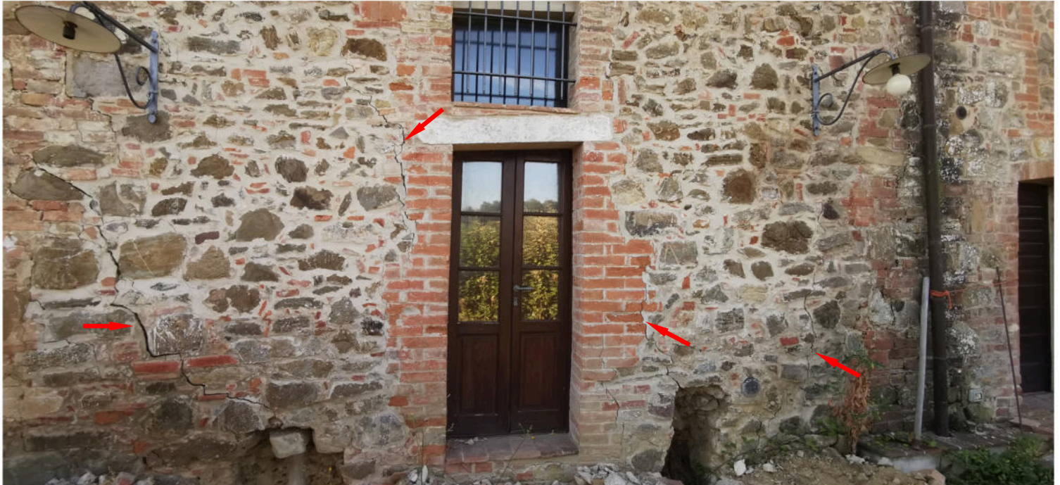
Foto 5 - Prospetto NORD vista fabbricato principale con evidenziazione delle lesioni
