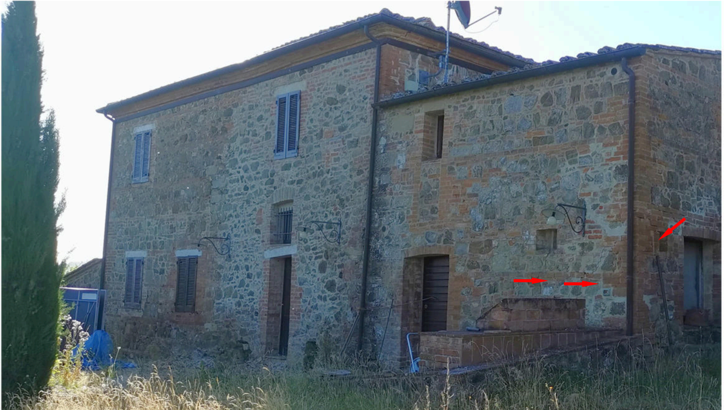
Foto 3 - Prospetto NORD vista fabbricato principale e corpo minore 1 con evidenziazione delle lesioni
