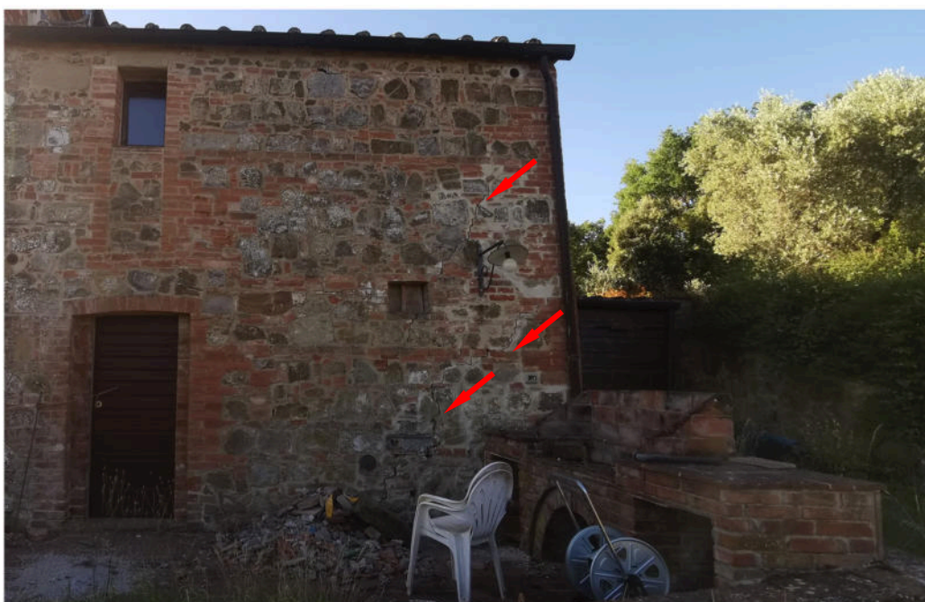
Foto 4 - Prospetto NORD vista corpo minore con evidenziazione delle lesioni
