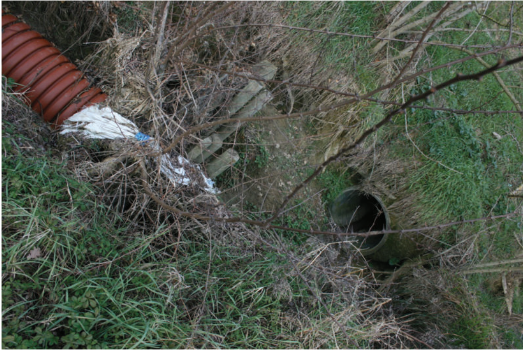
Figura 7.18 – Fotografia 3, vista del tombamento a monte della strada
